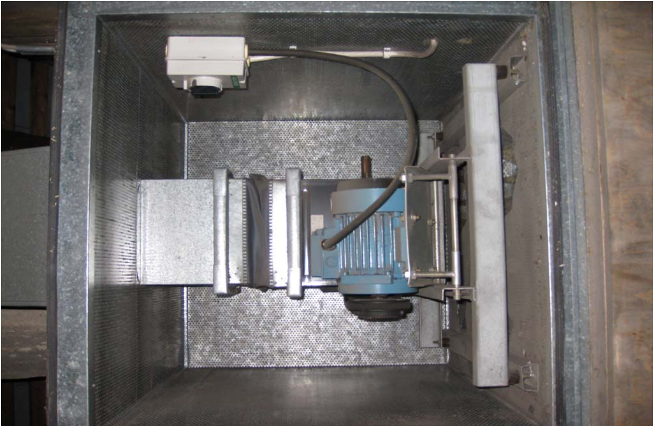
LVI-kuva 3. Ilmanvaihtokone on huollettu ja puhdas.
