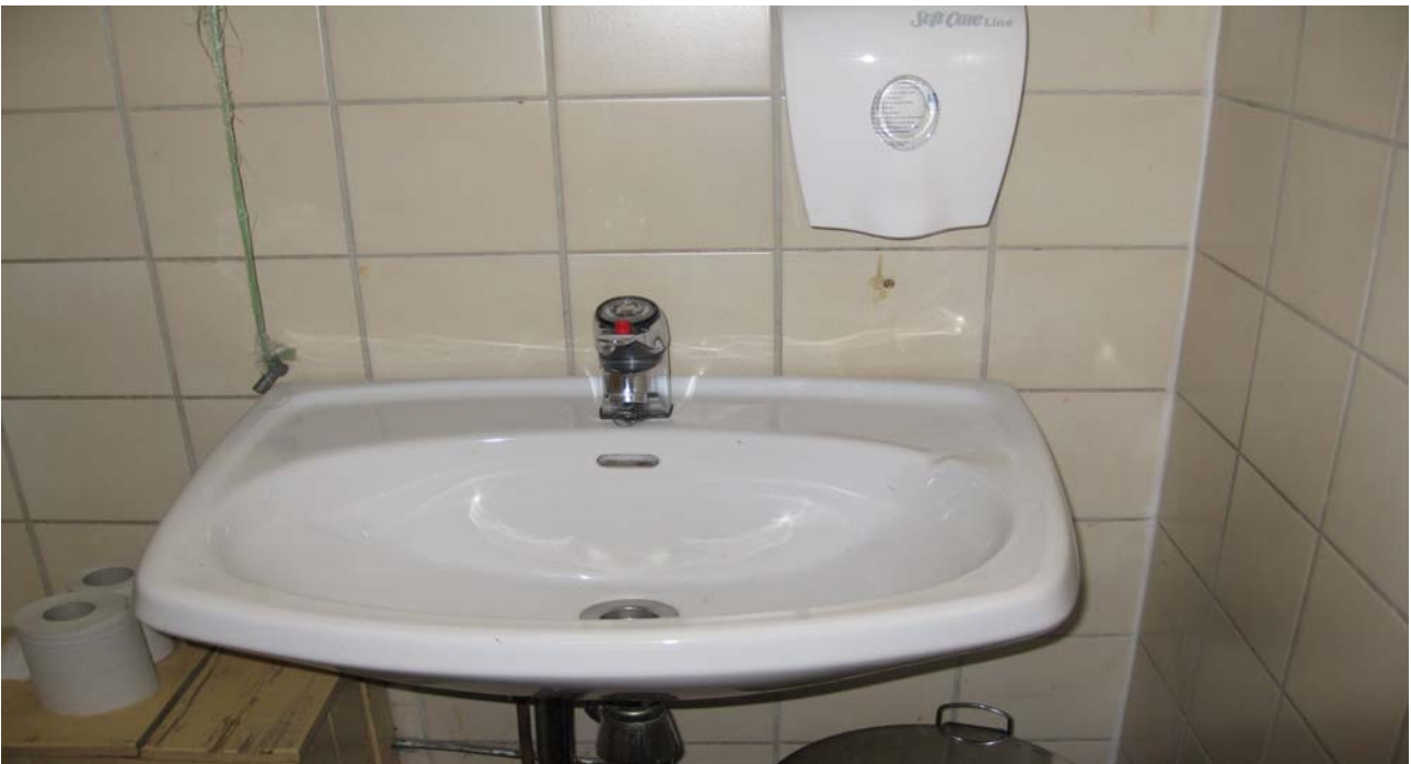
LVI-kuva 2. Yleiskuva vesikalusteista.
