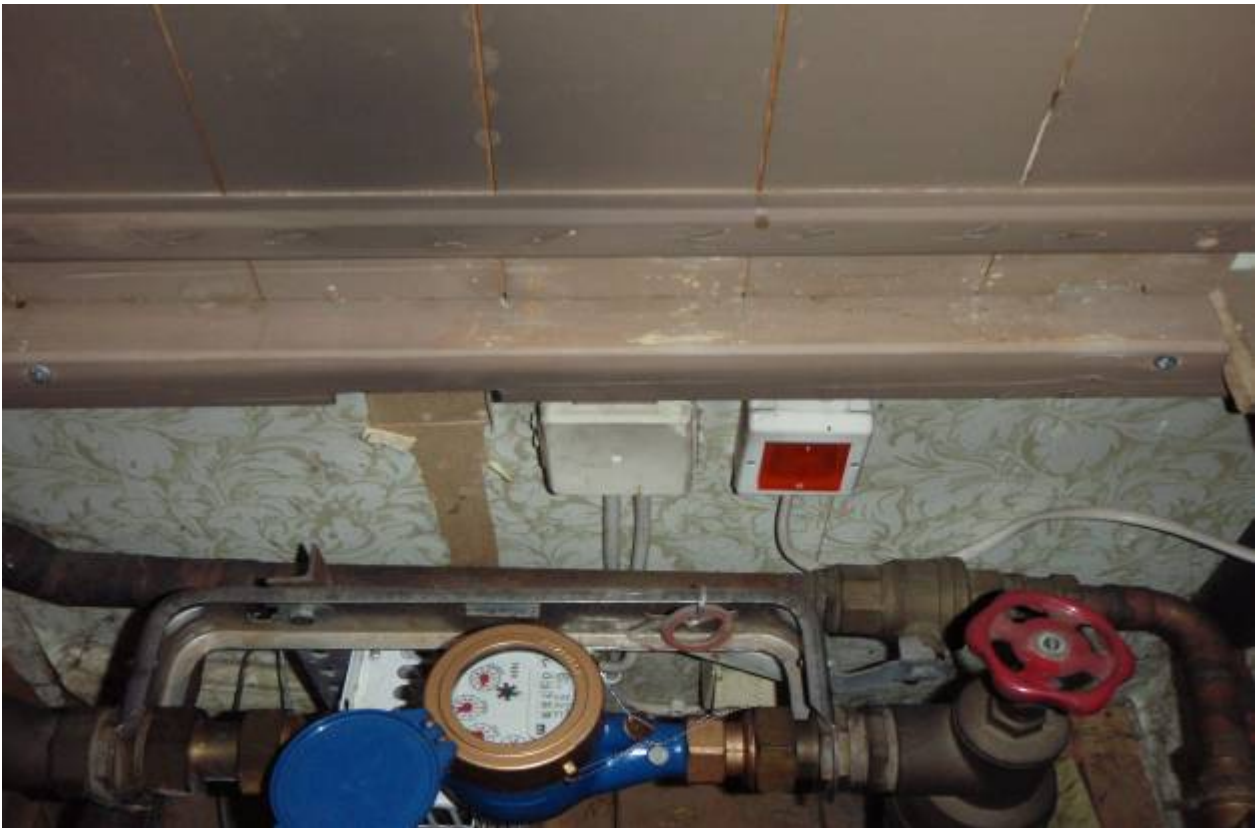
S-KUVA 7. Vesijohdon sulanapitolämmitys
