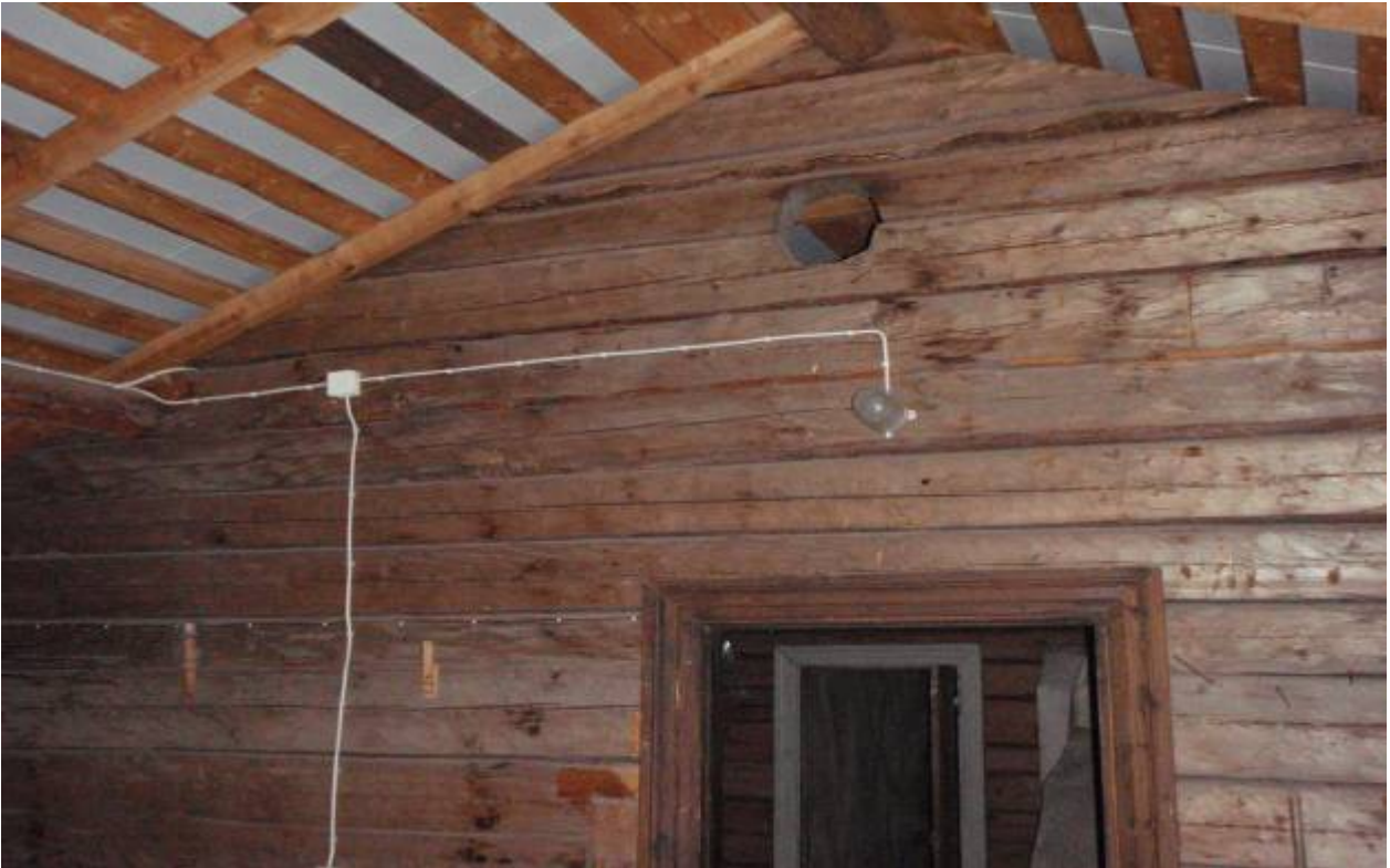
S-KUVA 5. Ullakkotilan valaistus
