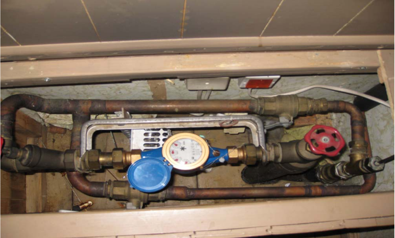
LVI-kuva 1. Yleiskuva vesimittarista ja pääsuluista.
